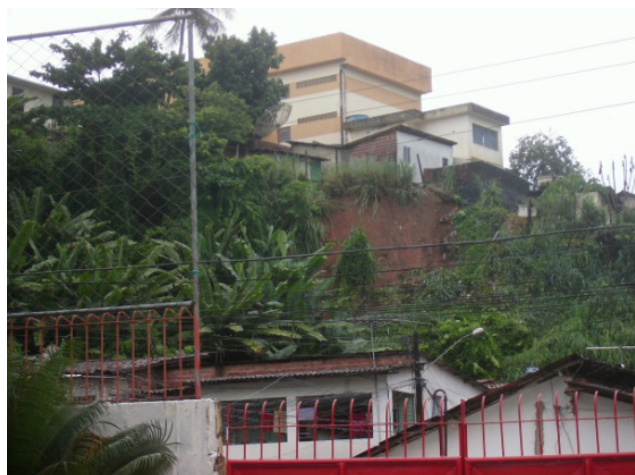
Figura 1. Parte da área de encosta, demonstrando o processo erosivo. Na parte superior da encosta, uma Creche que acolhe crianças do Ensino Fundamental I (2010).
